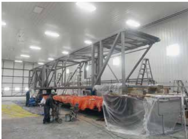
Die neue transportable Fördergerüstkonstruktion in der Lackieranlage
