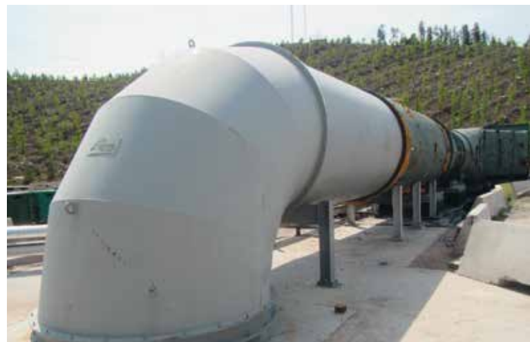
Luttenkrümmer und horizontale Übergangsleitung
