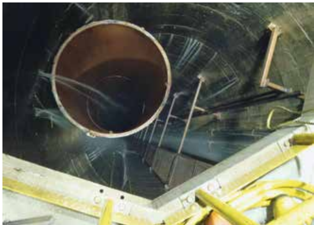
Blick von der Schwebebühne – vorhandene Wasserzuflüsse und Stahleinbauten
