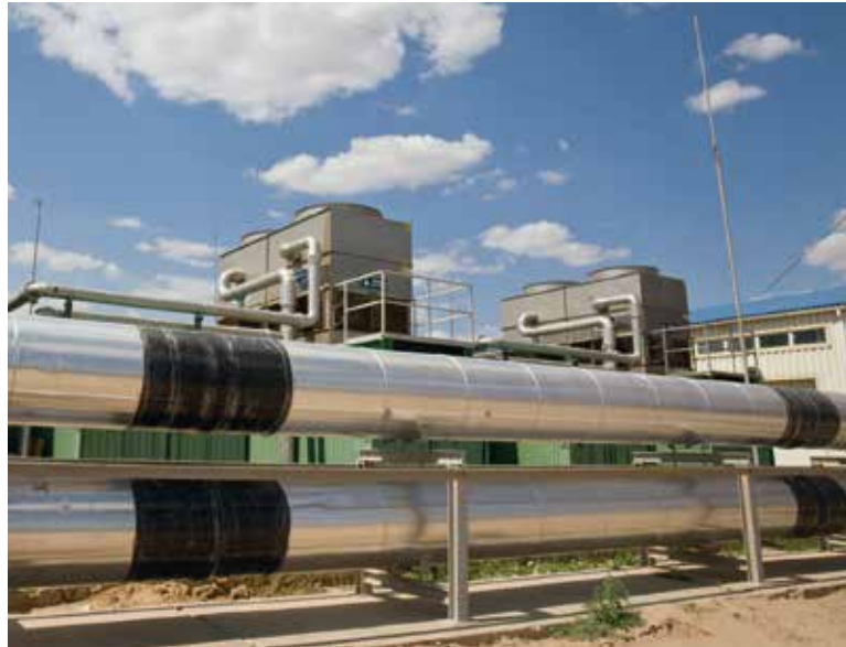
Isolierte Versorgungsleitungen zwischen Kältemaschinen und Schacht
