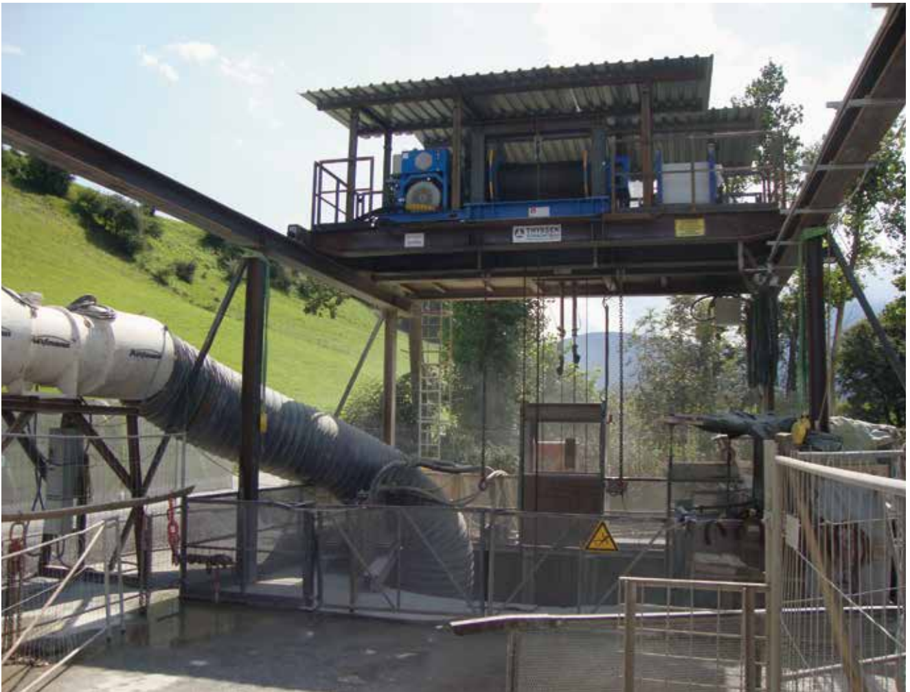
Schachtkopf inkl. Krananlage
