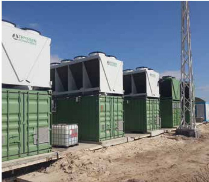
Kältemaschinen in Containerbauweise
