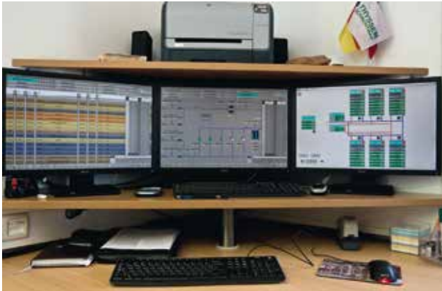
Arbeitsplatz zur Überwachung und Steuerung der Gefrieranlage
