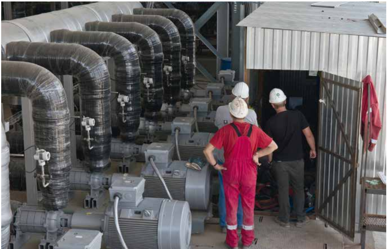
TS-Mitarbeiter bei der Kontrolle der Gefrieranlage
