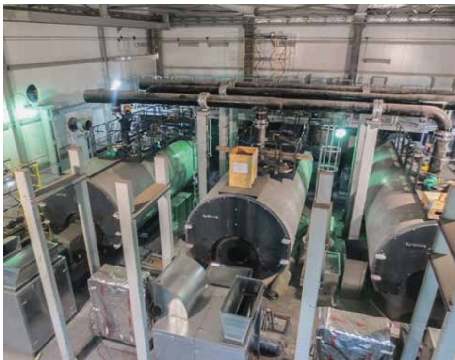
Anlage zur Wetterklimatisierung
