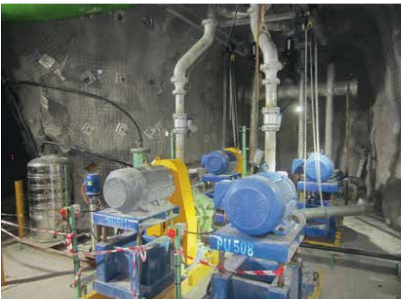
Zwei Stränge mit zwei in Reihe geschalteten 8/6 Warman-Pumpen am Aufstellungsort
