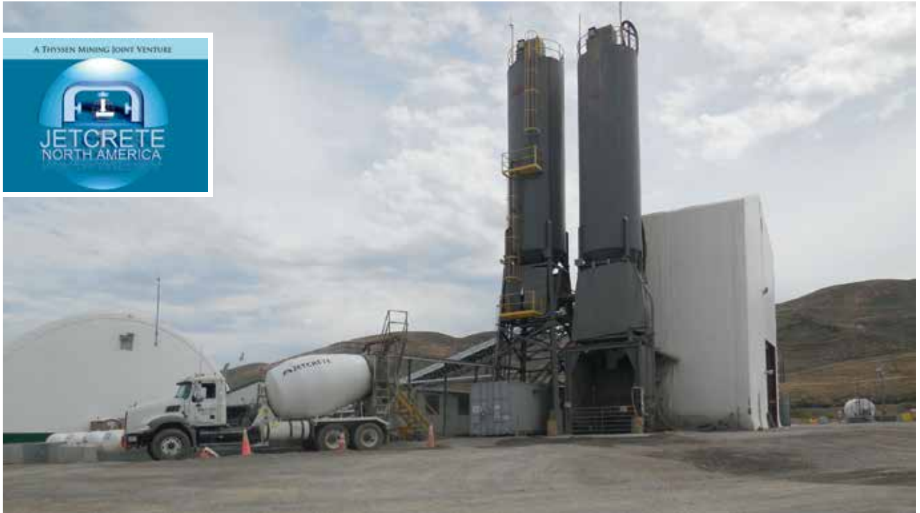
Hochmoderne Betonmischanlage am Bergwerk Leeville, Nevada
